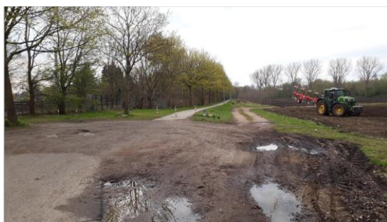
Abbildung 3: Mängel an der Fahrradstraße Bickbargen
